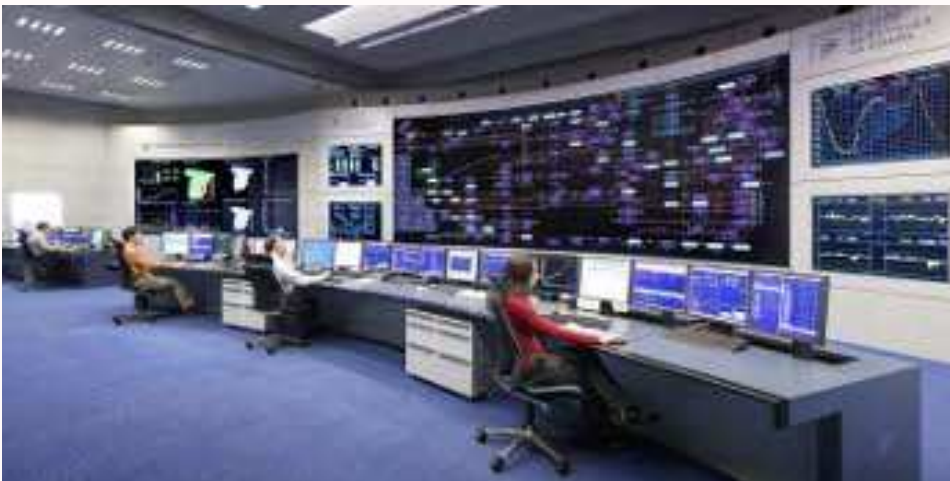
Figura 9. Centro de Control de Red Eléctrica de España Fuente: www.ree.es
